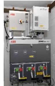
MS-schakelinstallatie met DA
